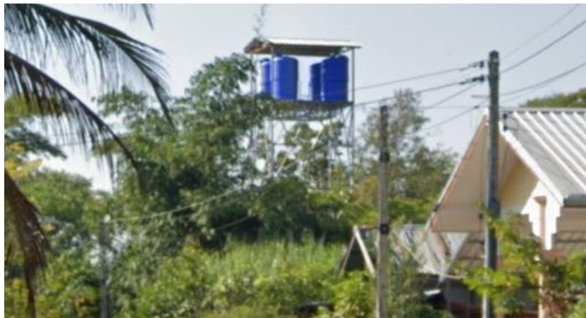
ระบบประปาบาดาล หมู่ที่ 6 บ้านหนองตอกเกี้ยว ตำบลหนองน้ำใส อำเภอบ้านไผ่ จังหวัดขอนแก่น
